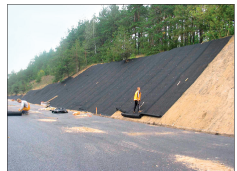
Abbildung 3: Erosionsschutz an Autobahnen
