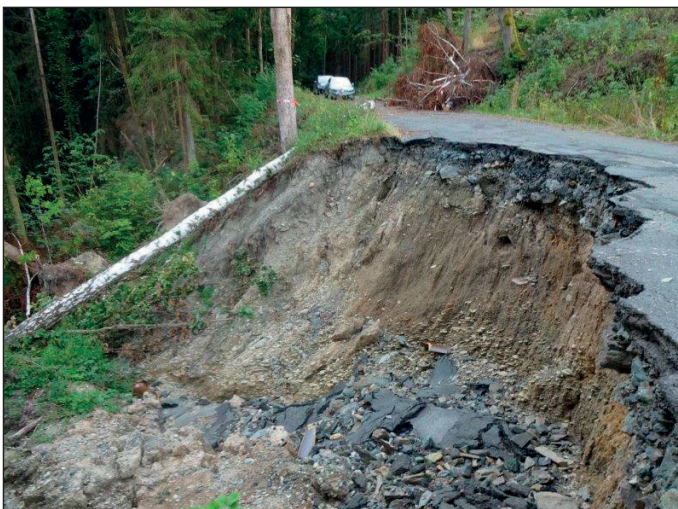
Abb. 3: Straßenabbruch durch Erosionsschaden
