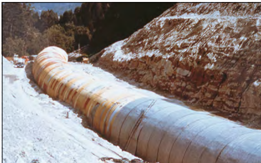
Bild 64 Druckfreies Ableiten von Niederschlags- und Grundwasser mit Secudrain® im Tunnelbau (Pustertal)
