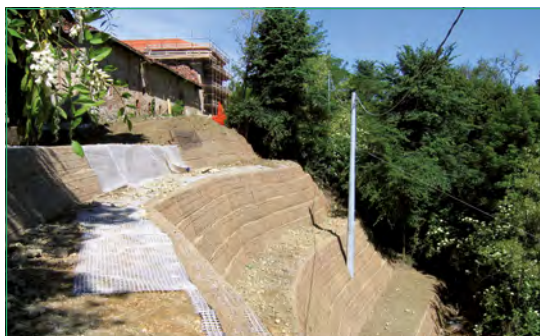
Bild 52 Bewehrte Steilböschung nach dem Umschlagverfahren mit verlorener Stahlgitterschalung und Begrünungsmatte als Außenhaut
