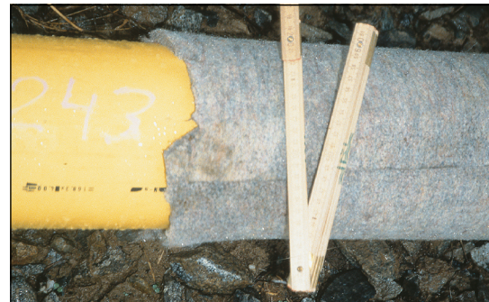
Bild 84 Secutex® Schutzvliesstoff als Rohrummantelung (Arnstorf)
