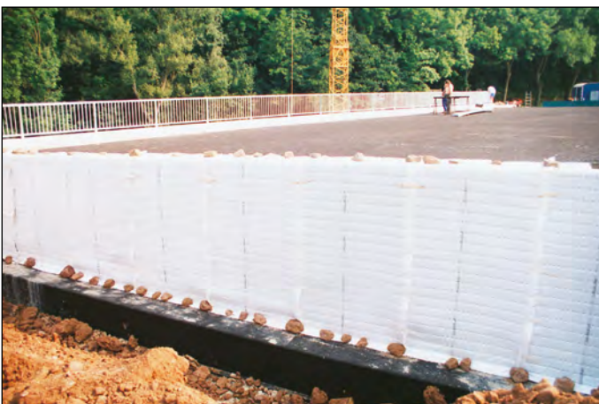
Bild 9 Secudrain® geosynthetisches Dränsystem als Entwässerung an einem Brückenwiderlager
