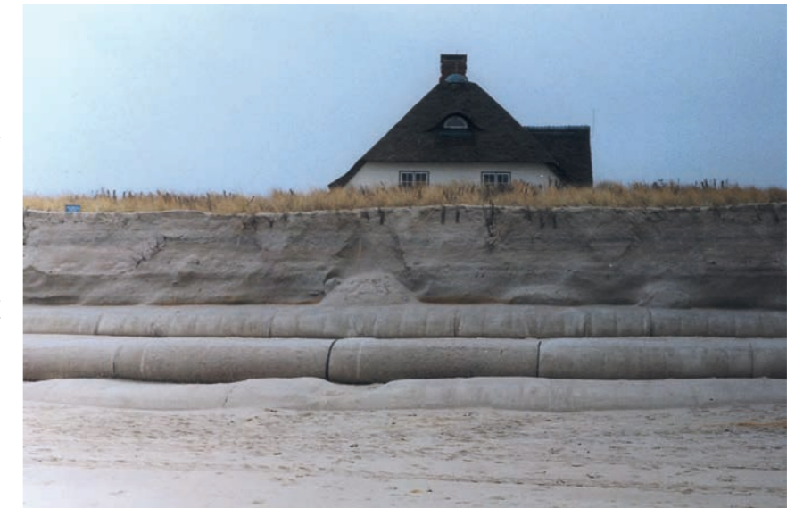
Abb. 4 Nach Sturmflut und Abtrag des Sanddepots freigespülte Sandpolster
