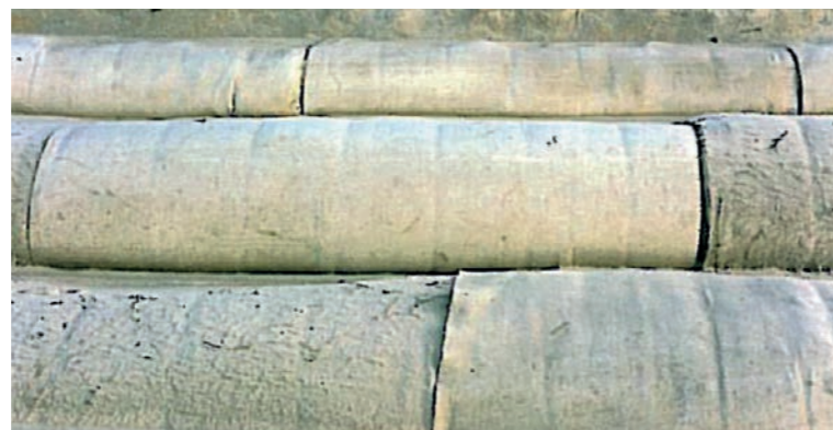
Abb. 5 Detail der Frontausbildung nach Freilegung durch Sturmflut
