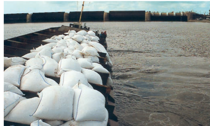
Bild 8. Kolkstabilisierung am Eidersperrwerk (1993): Einbau von 48.000 Sandcontainern. Fig. 8. Scour stabilisation to the Eider flood barrier (1993): Placing of 48,000 sand containers.
