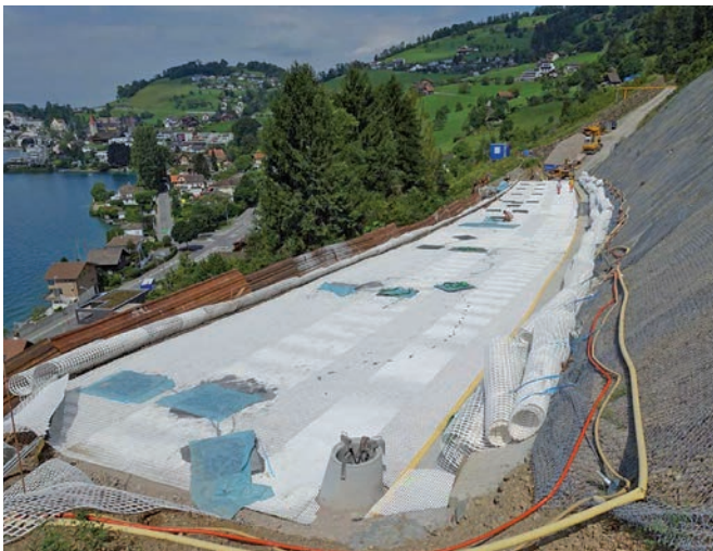
Fig. 10 Horizontal reinforcement of the load transfer platform as basis of the embankment [10] Lastverteilungspolster als Basis für den Steinschlagschutzdamm [10]
