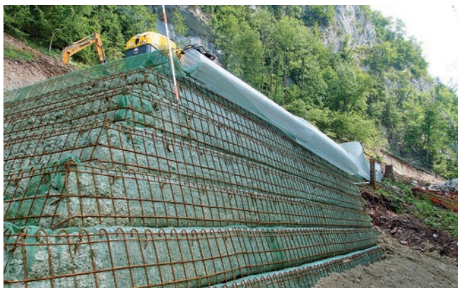
Fig. 6 Building of a rockfall embankment by wrap-around method with temporary formwork, Type IVb [4] Aufbau eines Steinschlagschutzdamms in Umschlagmethode mit temporärer Hilfsschalung, Bautyp IVb [4]
