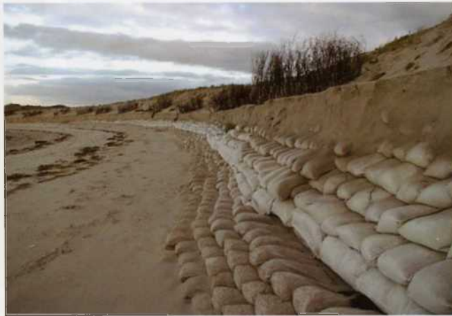
Abb. 6: Freigelegte Sandsackbarriere nach Orkantief »Jeanett« (28./29. Oktober 2002)
